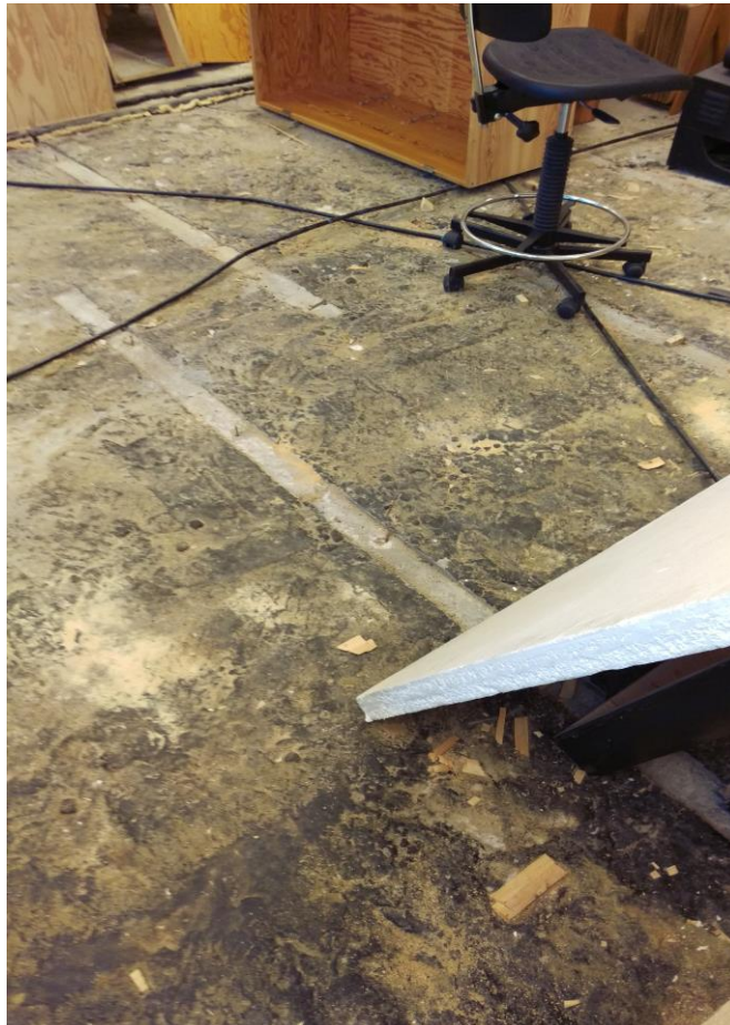
Foto 1. Upprivet innergolv i kemisalen på grund av vattenskada. Spikar sticker upp ur underlaget. forts
