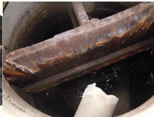
Mellanvägg i trä, risk för slamflykt.
