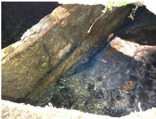
Skadad mellanvägg, risk för slamflykt.
